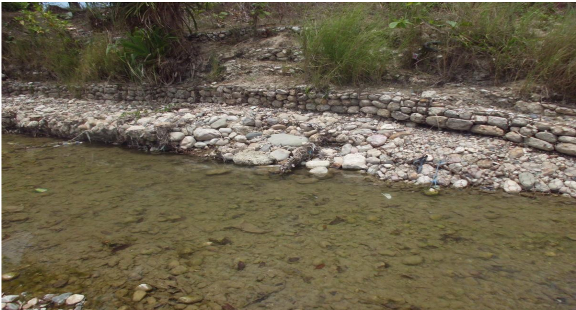
Gambar 1.1. Kerusakan bronjong pada Sungai Benanain
