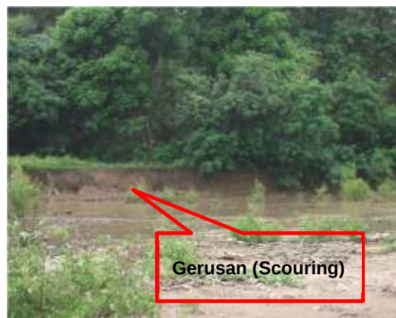
Gambar 1.6. Gerusan lahan warga Sumber : Dokumentasi, 2017
