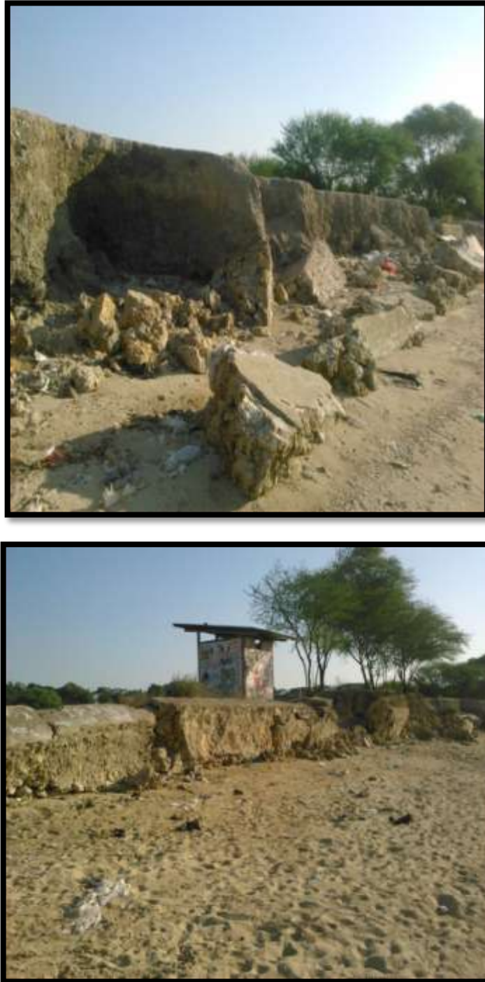
Gambar 1.2. Pengaruh Abrasi Terhadap Bangunan Pantai
