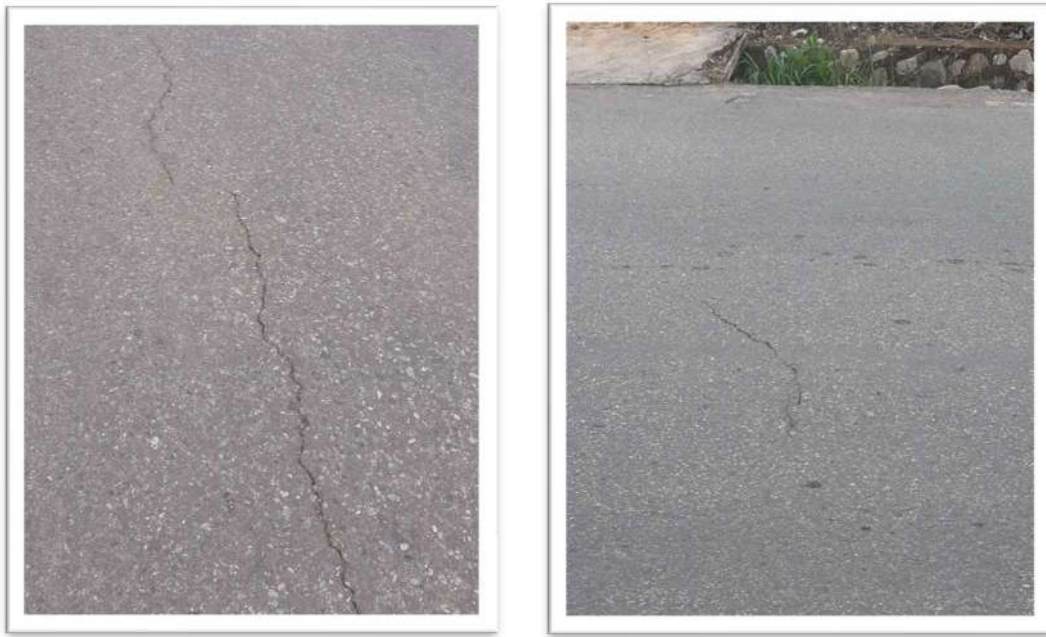
Gambar 1.4 Kondisi kerusakan perkerasan jalan Fetor Funay Kota Kupang jenis retak
