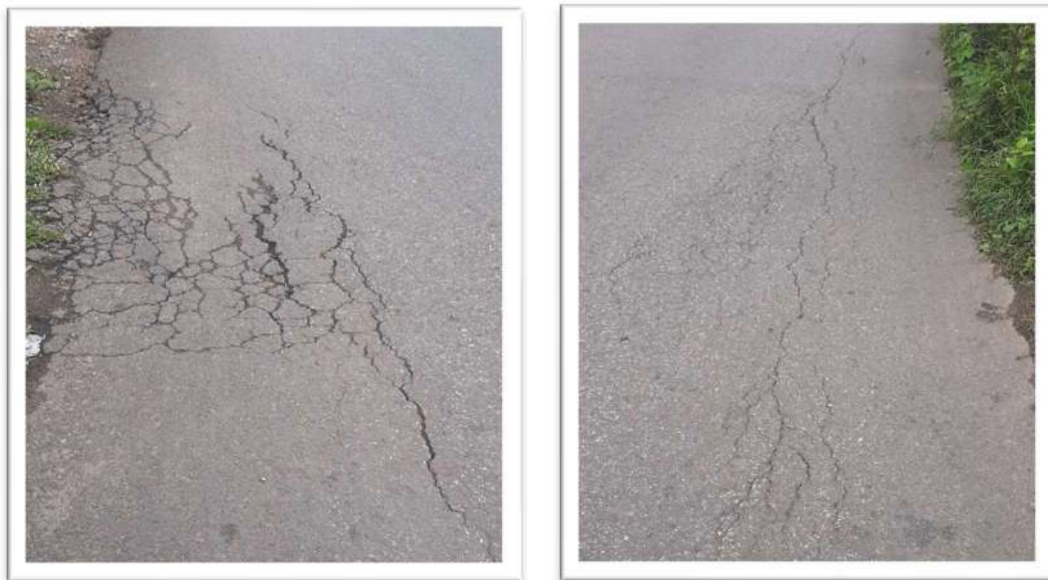
Gambar 1.4 Kondisi kerusakan perkerasan jalan Fetor Funay Kota Kupang jenis amblas
