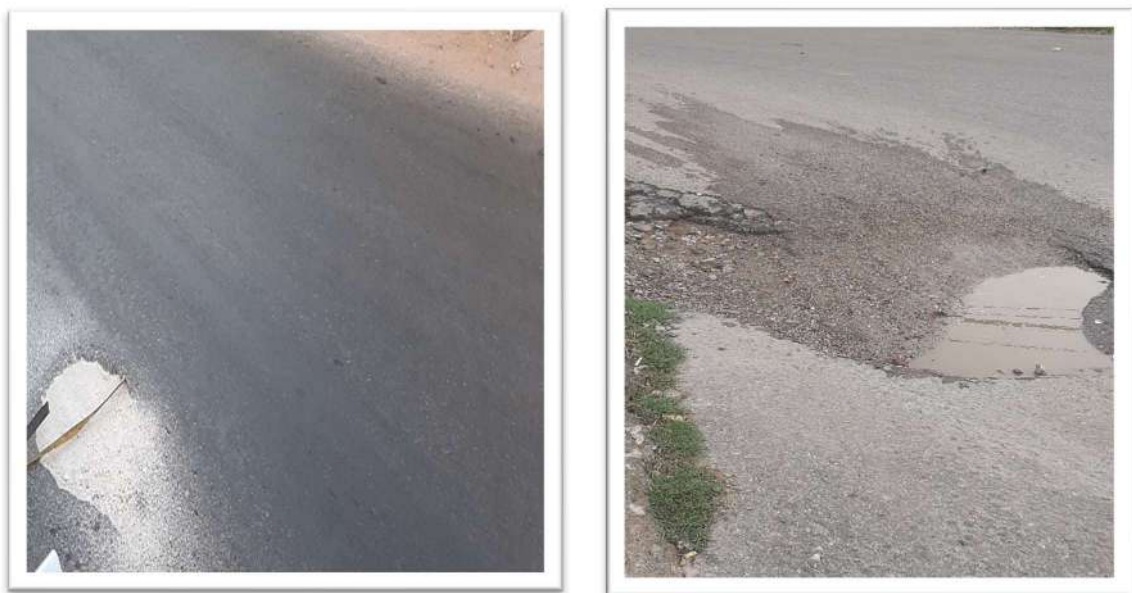
Gambar 1.3 Kondisi kerusakan perkerasan jalan Fetor Funay Kota Kupang jenis lubang
