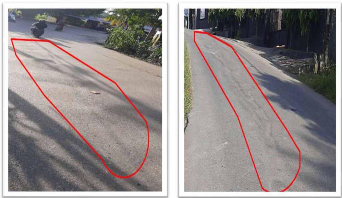
Gambar 1.2 Kondisi kerusakan perkerasan jalan Fetor Funay Kota Kupang jenis gelombang
