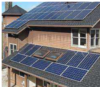
Gambar 221. Panel surya pada atap bangunan (Sumber : Google Images)
