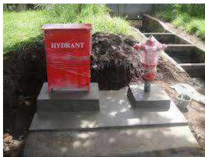
Gambar 216. Hydrant box dan hydrant pilar (Sumber : Google Images)
