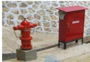
Gambar. 17 Sistem Pemadam Kebakaran
