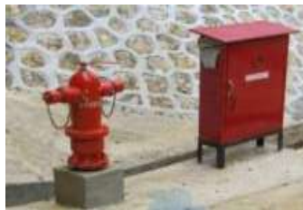
Gambar 151 Sistem pemadam kebakaran
