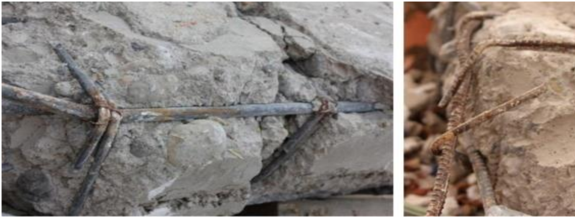
Gambar 2.42. Pola Kerusakan Akibat Detail Kait yang buruk (8)
