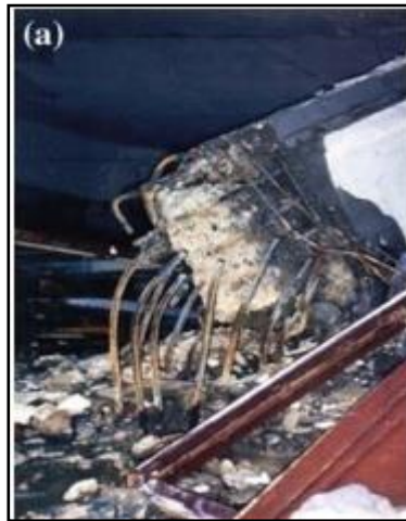
Gambar 2.48. Kegagalan pada sambungan tulangan kolom karena panjang sambungan lewatan tulangan yang terlalu pendek (tidak memenuhi syarat) (17)
