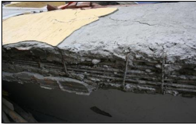
Gambar 2.43. Pola Kerusakan Akibat Spasi Sengkang yang besar (8)
