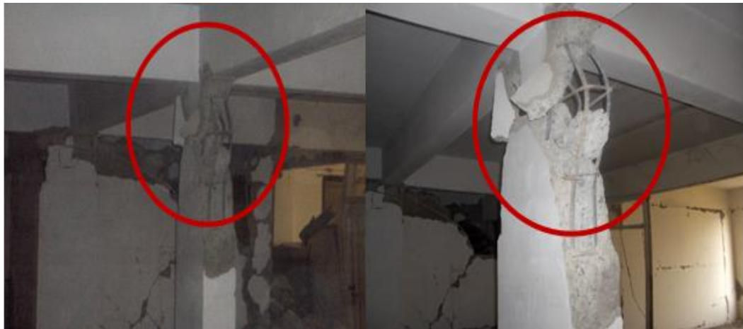
Gambar 2.41. Pola Kerusakan akibat Balok Kuat, Kolom Lemah (Gempa Kashmir 2005) (21)
