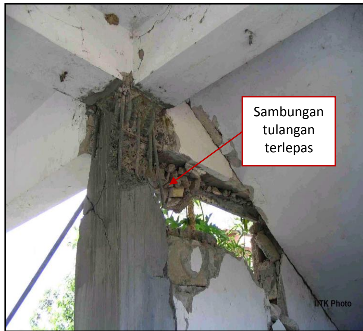
Gambar 2.46. Kegagalan pada sambungan tulangan kolom tidak terdapat sengkang sehingga sambungan tulangan (17)
