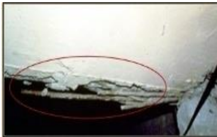
Gambar 2.44. Pola Kerusakan Akibat Spasi Sengkang yang besar (8)
