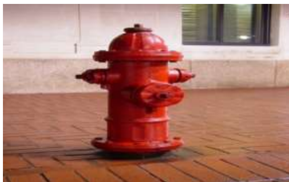
Gambar 4.18 pole hydrant (Sumber : Dwi tangoro, jurnal utilitas bangunan)
