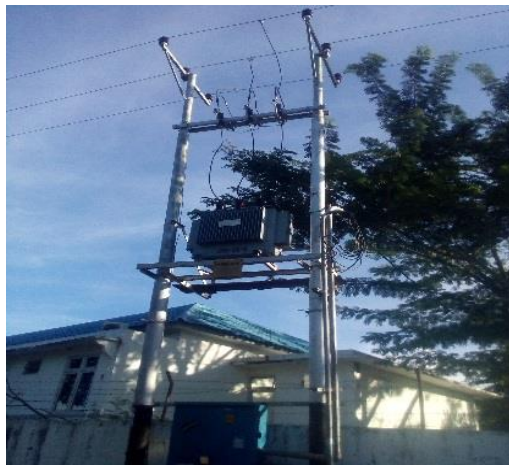
Gambar 3.7 Tiang Listrik pada lokasi perencanaan
