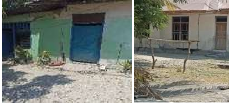
Gambar 1. 2 Kerusakan pada Rumah Masyarakat di Desa Tuapukan
