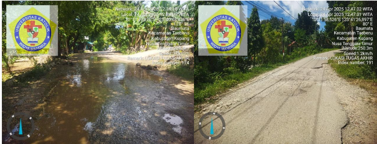
Gambar 1.1 Genangan air pada badan jalan dan pelepasan butiran agregat
