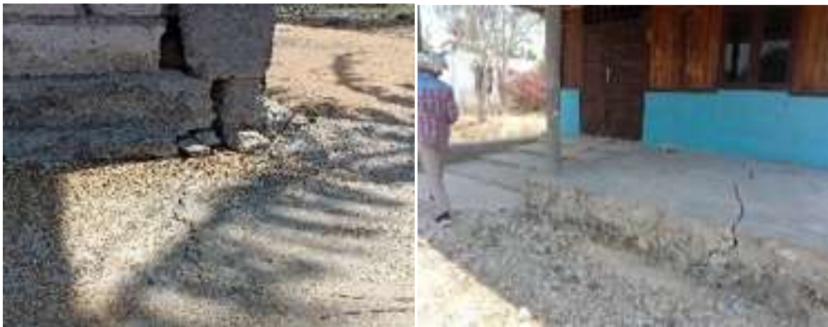
Gambar 1. 1 Kerusakan Rumah Warga
