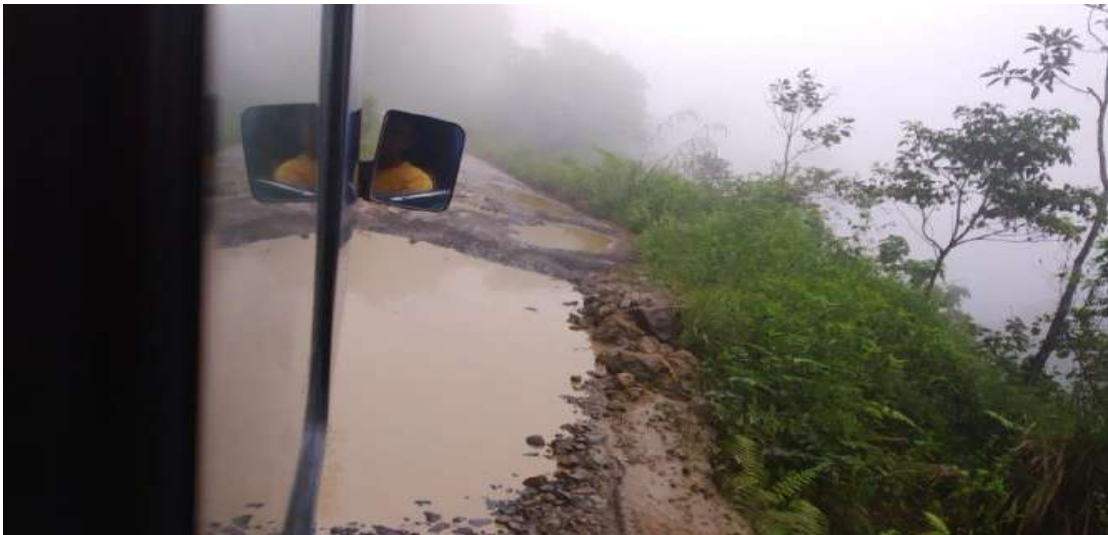
Gambar 4.1 Kerusakan Ruas Jalan Ruteng-Iteng
