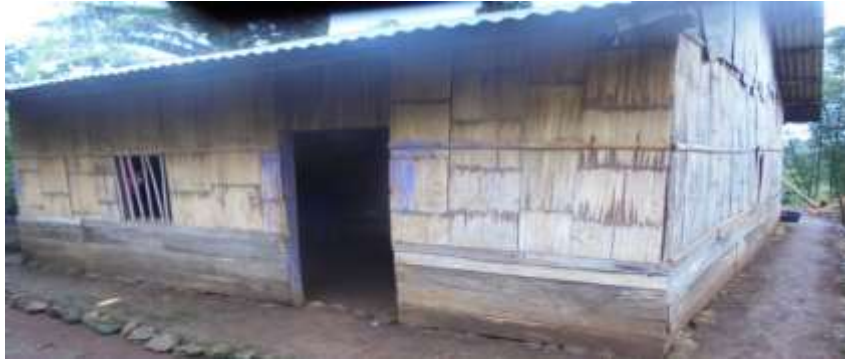
Kondisi Rumah Tidak Layak Huni.
