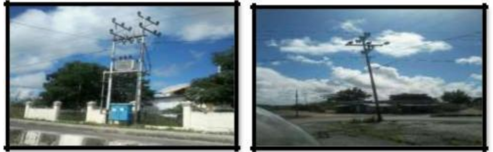
Gambar 18. Gardu Induk dan tiang listrik Sumber : Dokumentasi Pribadi
