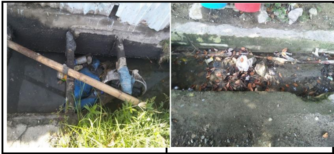
Gambar 1.1. Kondisi Drainase pada ruas Jalan Umbu Tipuk Marisi
