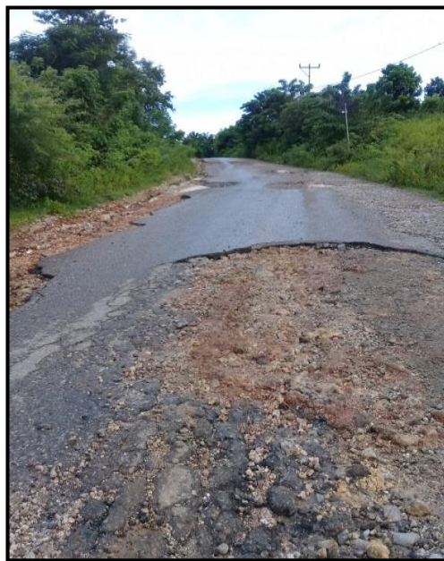
Gambar 1.1 Kondisi Ruas Jalan Tilog DAM
